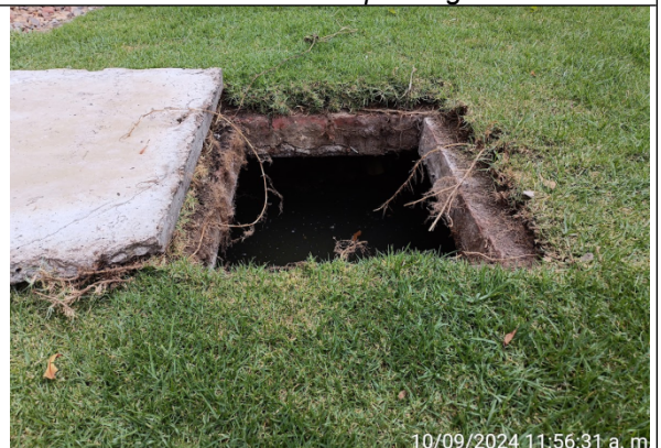
Foto No. 6. Pozo séptico
